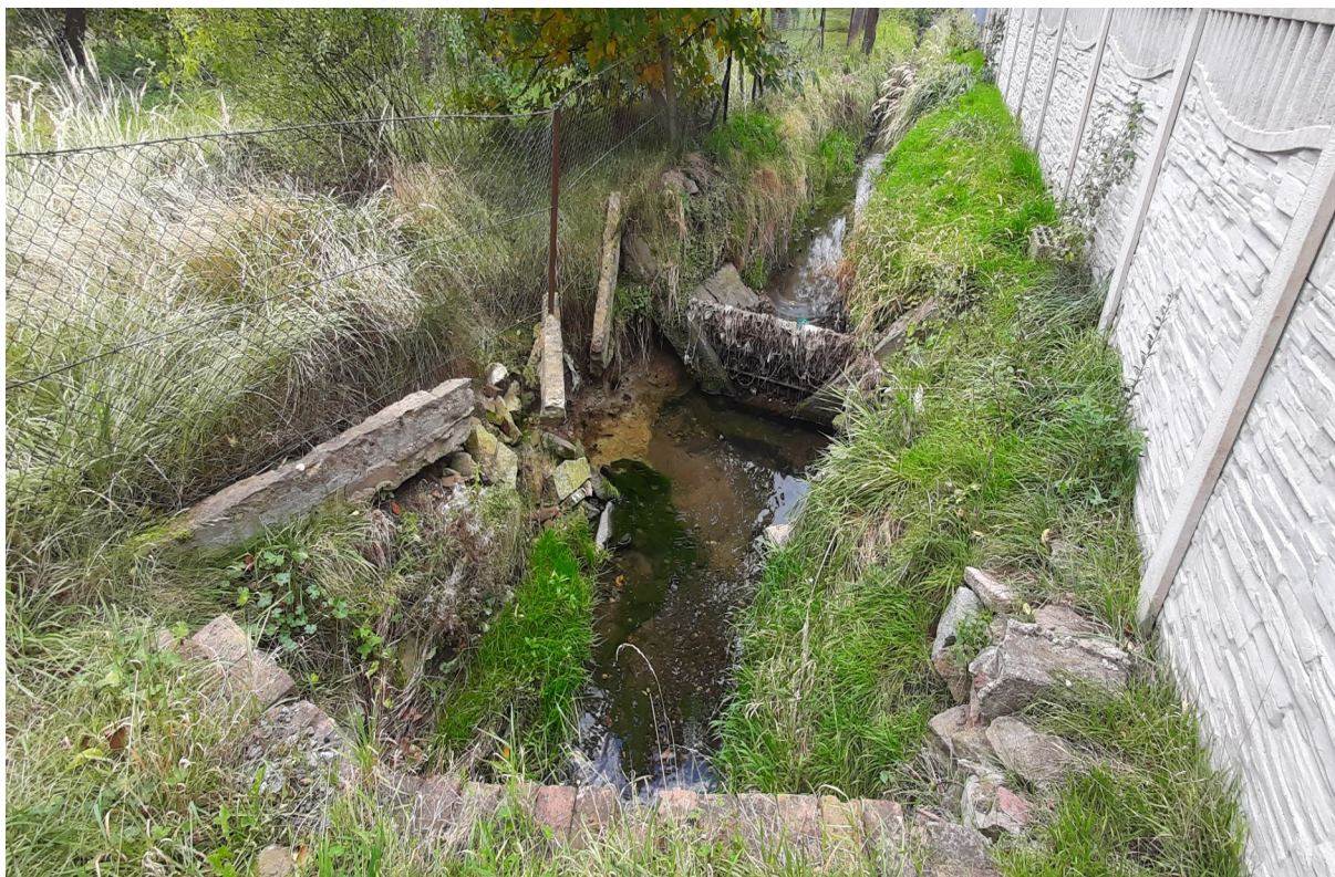
Fot.2. Uszkodzony wlot rowu do kanalizacji deszczowej przy ul. Krótkiej. Widoczny prefabrykowany element betonowy z kratą stalową.
