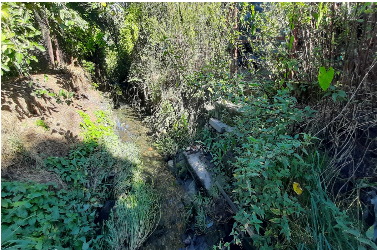
Fot.5. Widok rowu na wysokości działki nr 816 (ul. Niecała nr 10).
