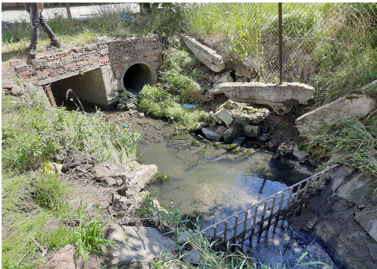
Fot.1. Uszkodzony wlot rowu do kanalizacji deszczowej przy ul. Krótkiej.
