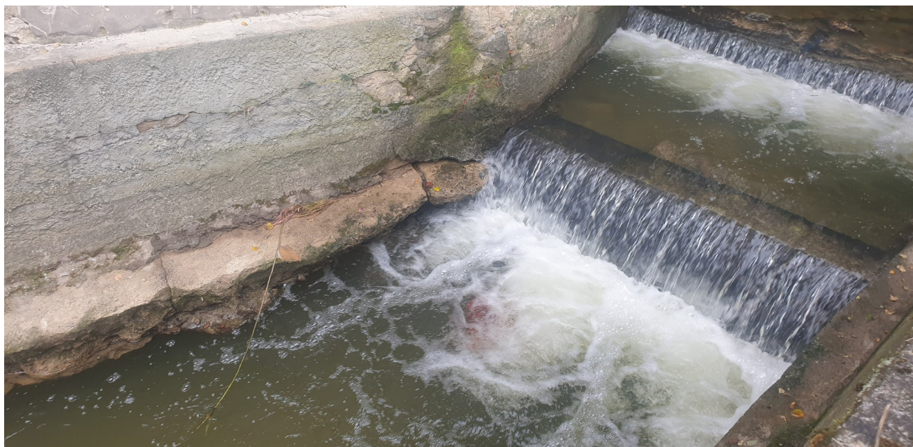
Fot.1. Uszkodzony mur koryta i odsadzka fundamentu budynku
